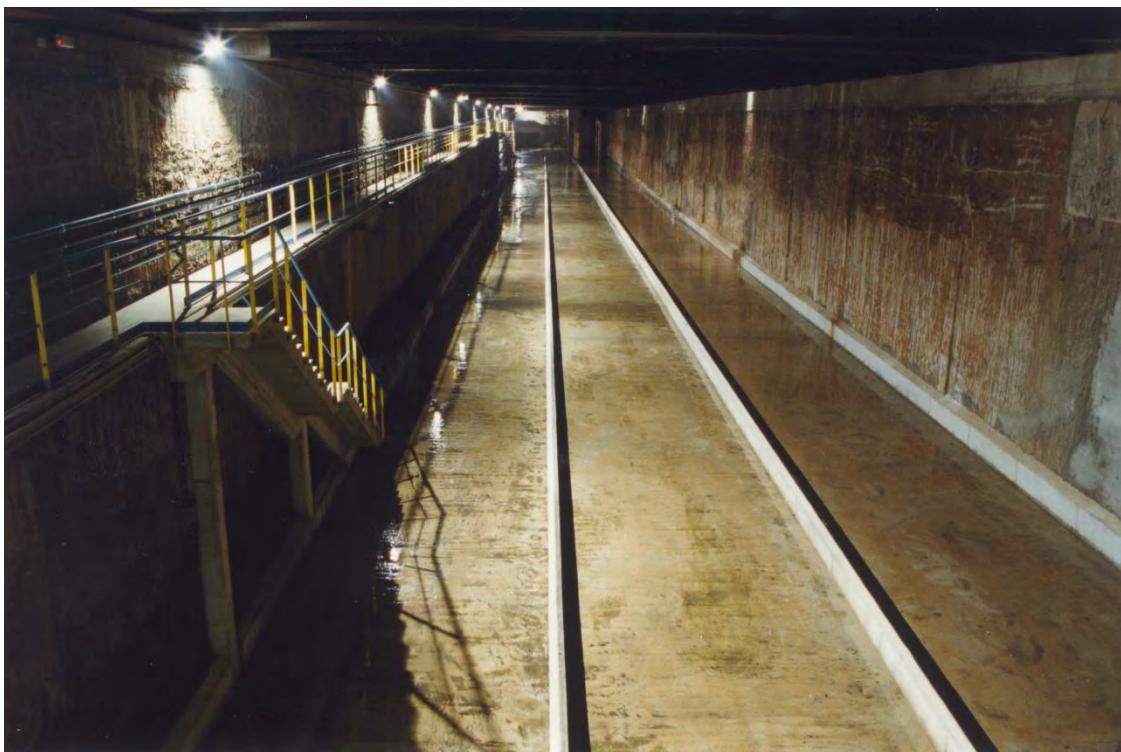
Figura 40 Ejemplo de pasarelas y escaleras de acceso a la solera en tanque de Bori Fontestà (Barcelona)
