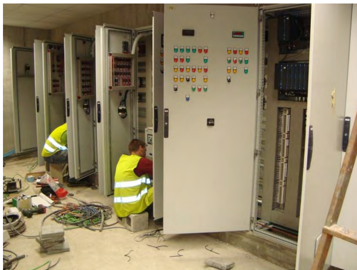
Figura 79 Cuadro de maniobras del tanque de Urgell (Barcelona).
