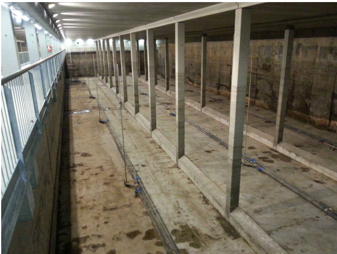
Figura 17 Cámara de retención del tanque José Manuel Obrero (Alicante).
