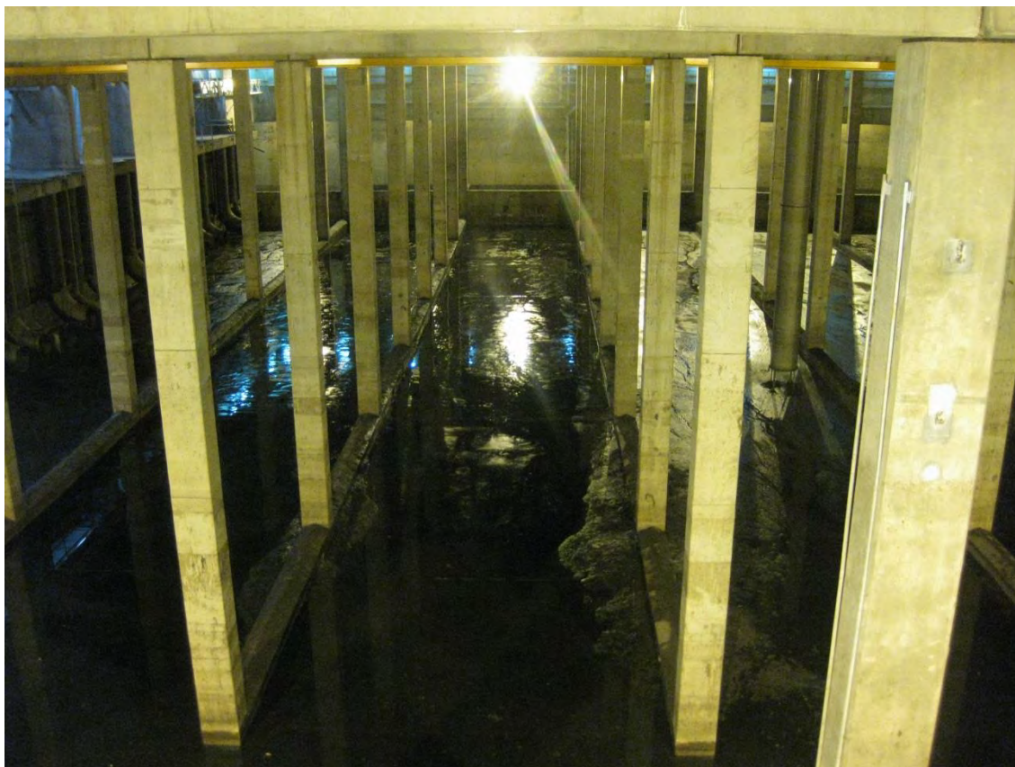
Figura 91 Tanque de tormentas de Butarque
