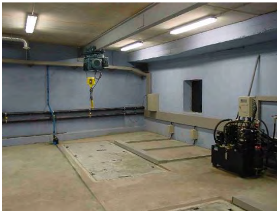
Figura 84 Locales técnicos, tapas de extracción de equipos y polipasto
