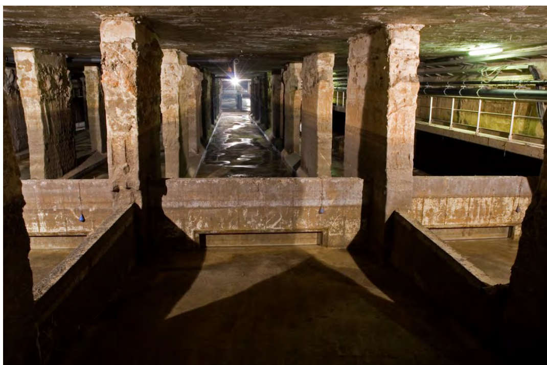
Figura 62 Tanque de Taulat en Barcelona con sistema de limpieza de cisternas en solera y clapetas.
