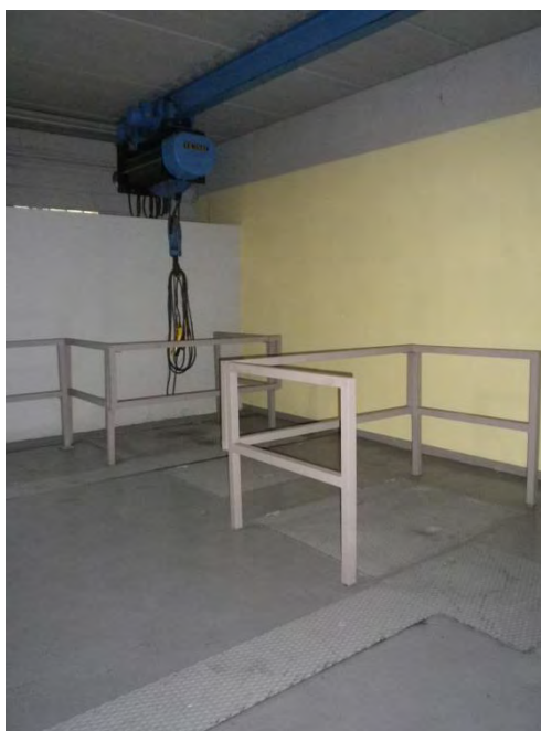
Figura 95. Sala de bombeo con polipasto para extracción de bombas
