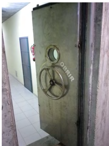
Figura 88 Acceso a los locales técnicos mediante compuerta estanca
