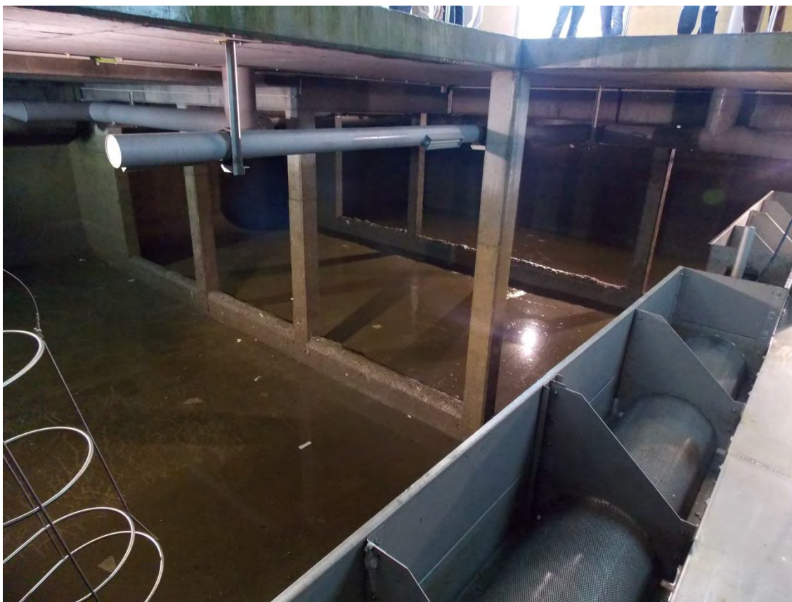
Figura 34 Tanque de tormentas en Lugo.
