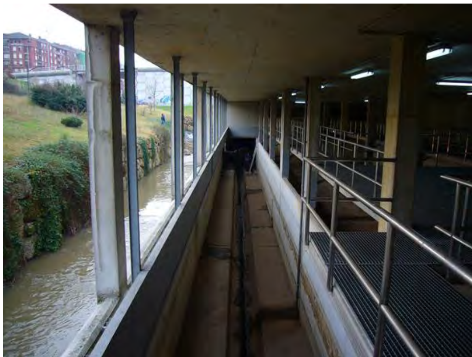
Figura 83 Tanque de tormentas con ventilación natural a la derecha, canal central circulación agua residual y aliviadero a la izquierda
