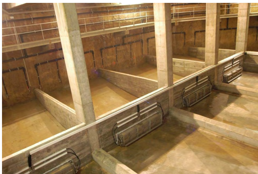
Figura 48 Ejemplo de cámaras de descarga y clapetas en el tanque de Vilalba dels Arcs (Barcelona)
