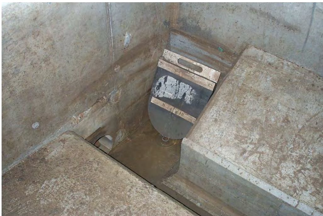
Figura 42 Clapeta antiretorno en tanque Louro (Pontevedra)
