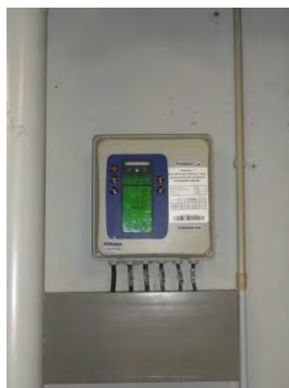
Figura 93 Detector de gases a la entrada de un tanque
