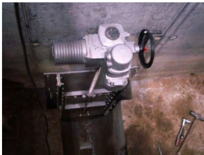
Figura 20 Compuerta con accionamiento eléctrico
