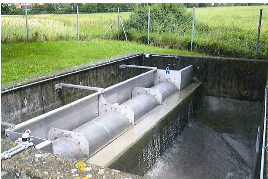
Figura 31 Tamiz rotativo automático colocado en un aliviadero
