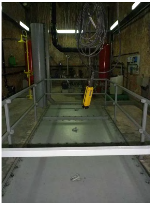
Figura 85 Acceso al mantenimiento de las bombas
