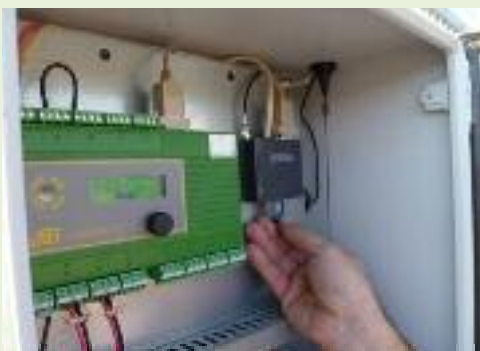
Figura 3.12 Dispositivo para el control del caudal captado y caudal ecológico
