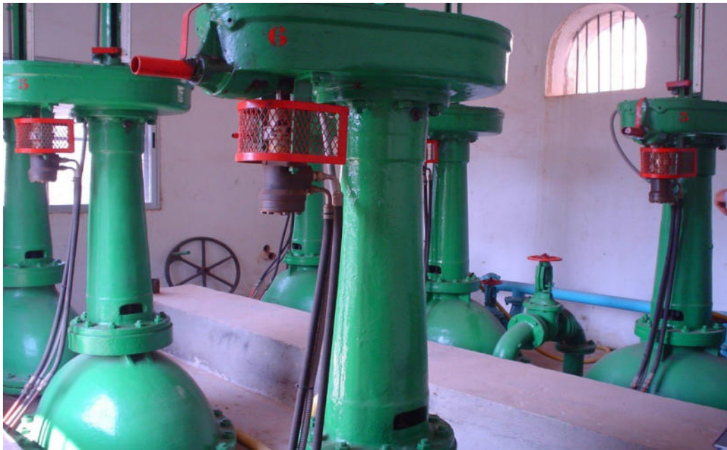
Válvulas de las tomas de riego.
