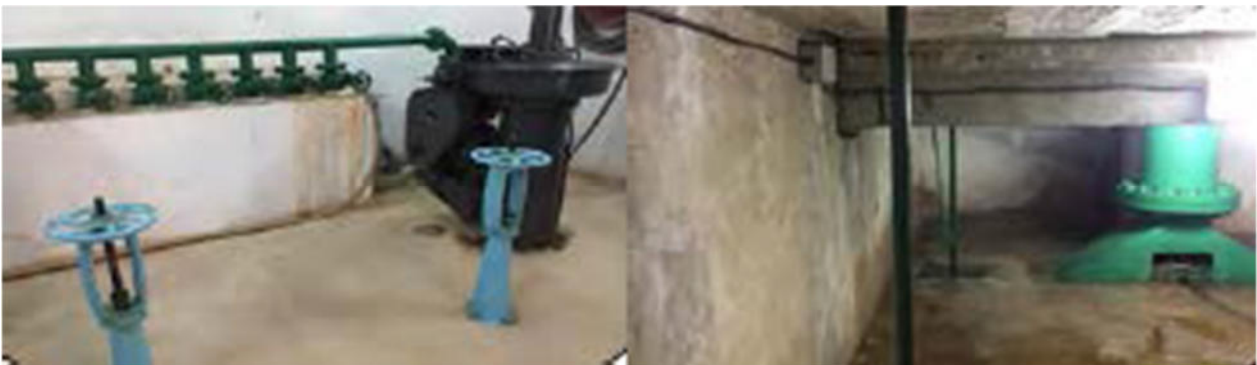
Equipos instalados en la cámara de compuertas del desagüe de fondo de la presa.
