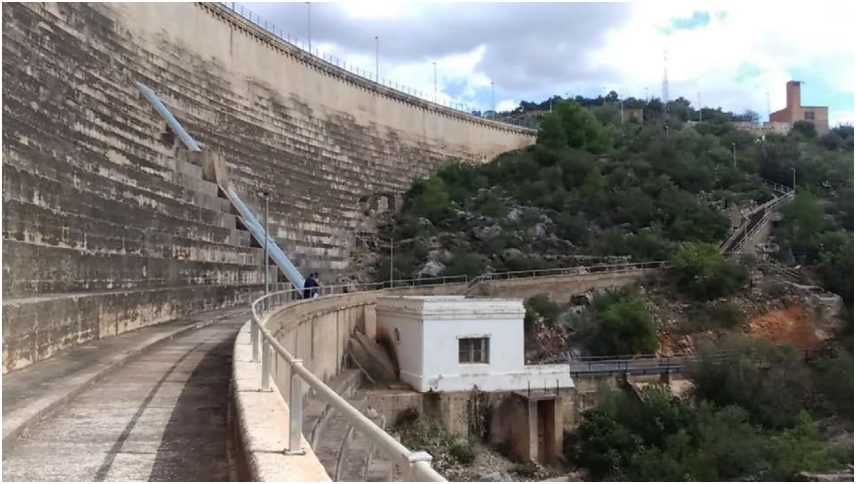
Vista del paramento de aguas debajo de la presa. Edificio de maniobra de tomas de riego.
