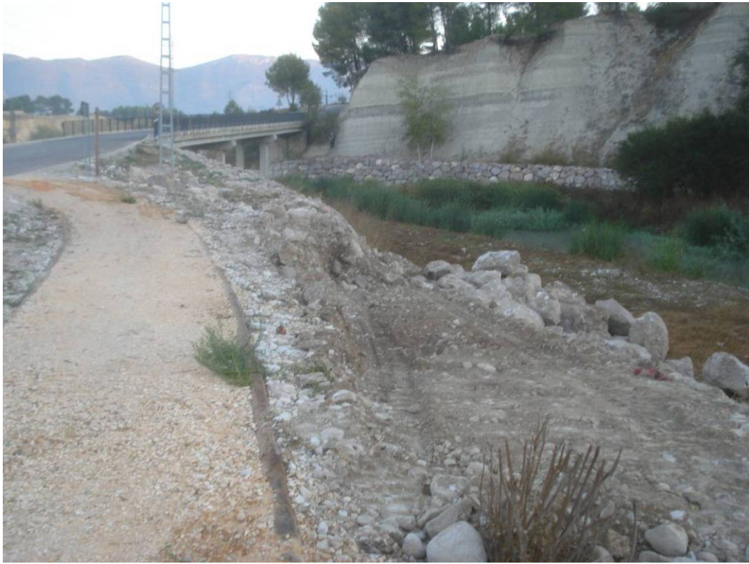
Aspecto del punto de inicio de la senda antes de los trabajos.
