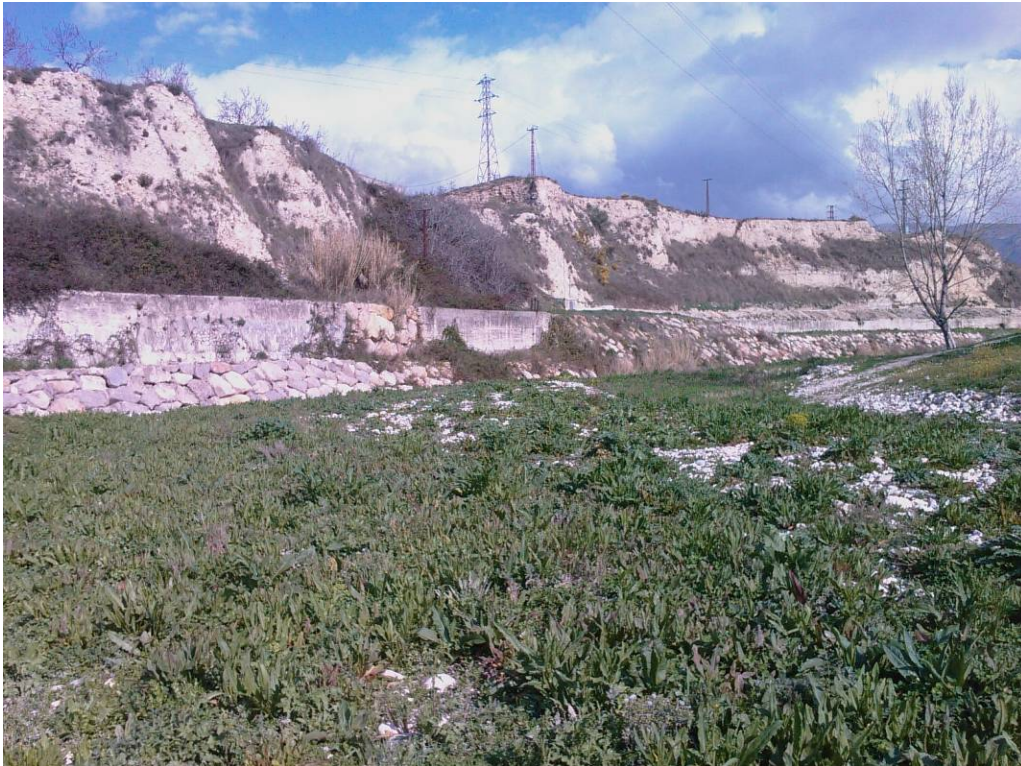
Aspecto de un depósito de acarreos existente en el cauce antes de los trabajos, sobre el que incluso se estaba asentando vegetación.
