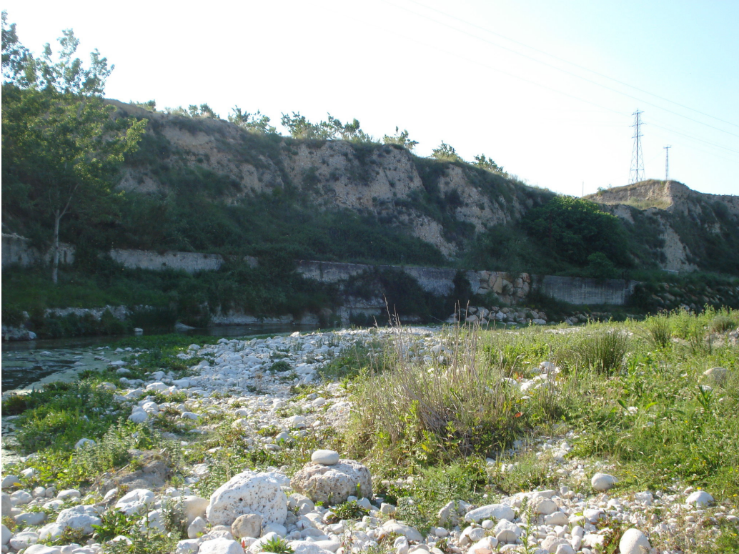
Estado inicial de las gravas en el lecho y de la escollera preexistente.
