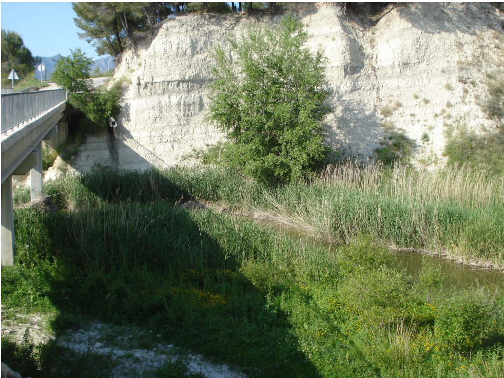
Estado de erosión de la margen junto estribo de puente existente.
