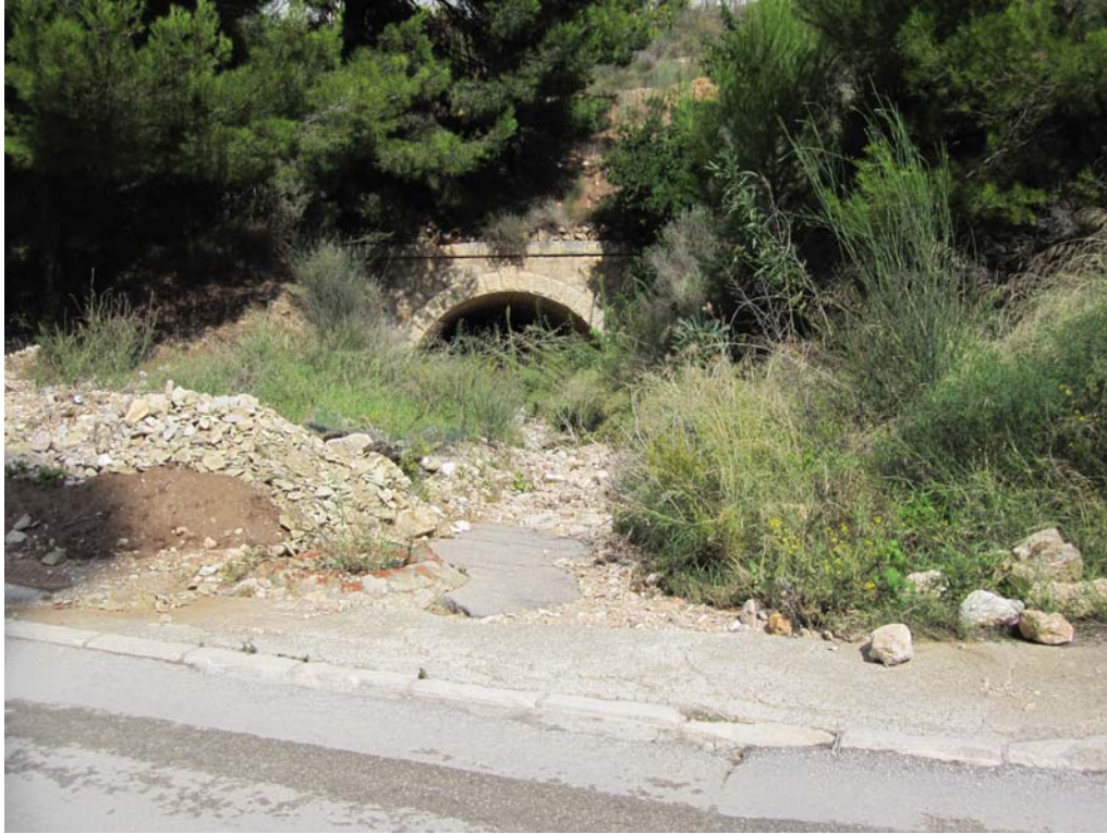
Acumulación obstructiva de acarreos y vegetación a la salida de una obra de drenaje.
