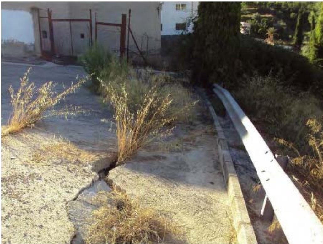
Indicios de desplazamiento de la cabeza del talud tras el colapso del antiguo muro de hormigón.
