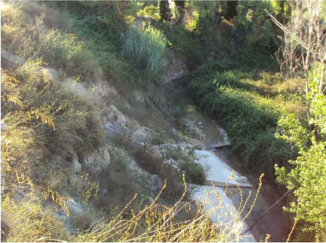
Estado del antiguo muro de hormigón volcado y dificultando la circulación de la corriente.
