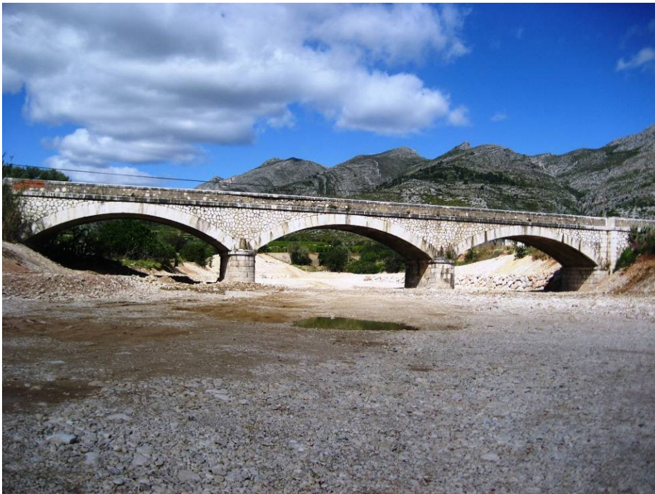
Río Girona. Aspecto de su lecho tras la actuación.
