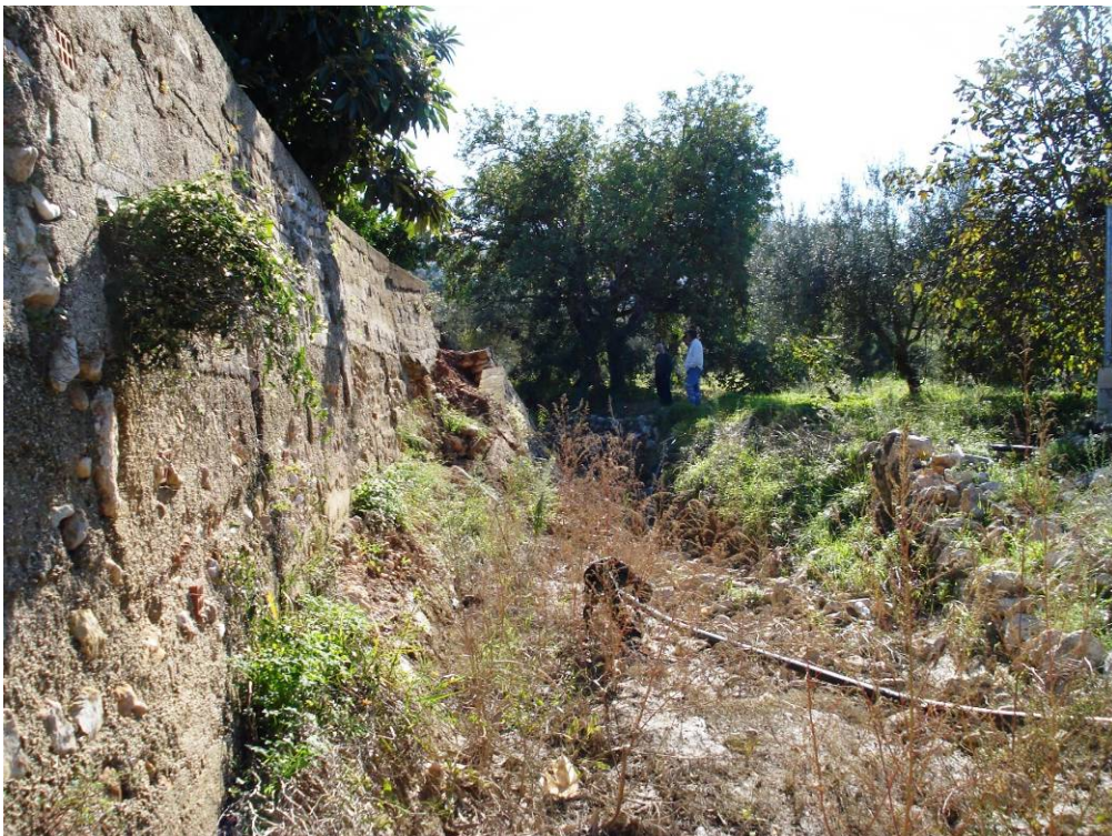
Barranco de Orbeta. Aspecto de desplome de margen antes de la actuación.
