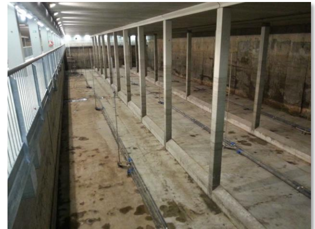
Cámara de retención de un tanque de tormenta en Alicante
