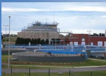
EDAR de Almenara
