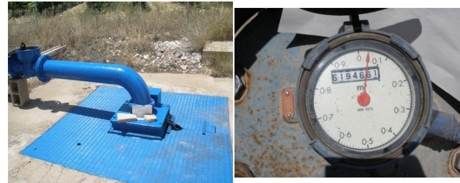
Contador volumétrico instalado a la salida de un pozo en Villena.
