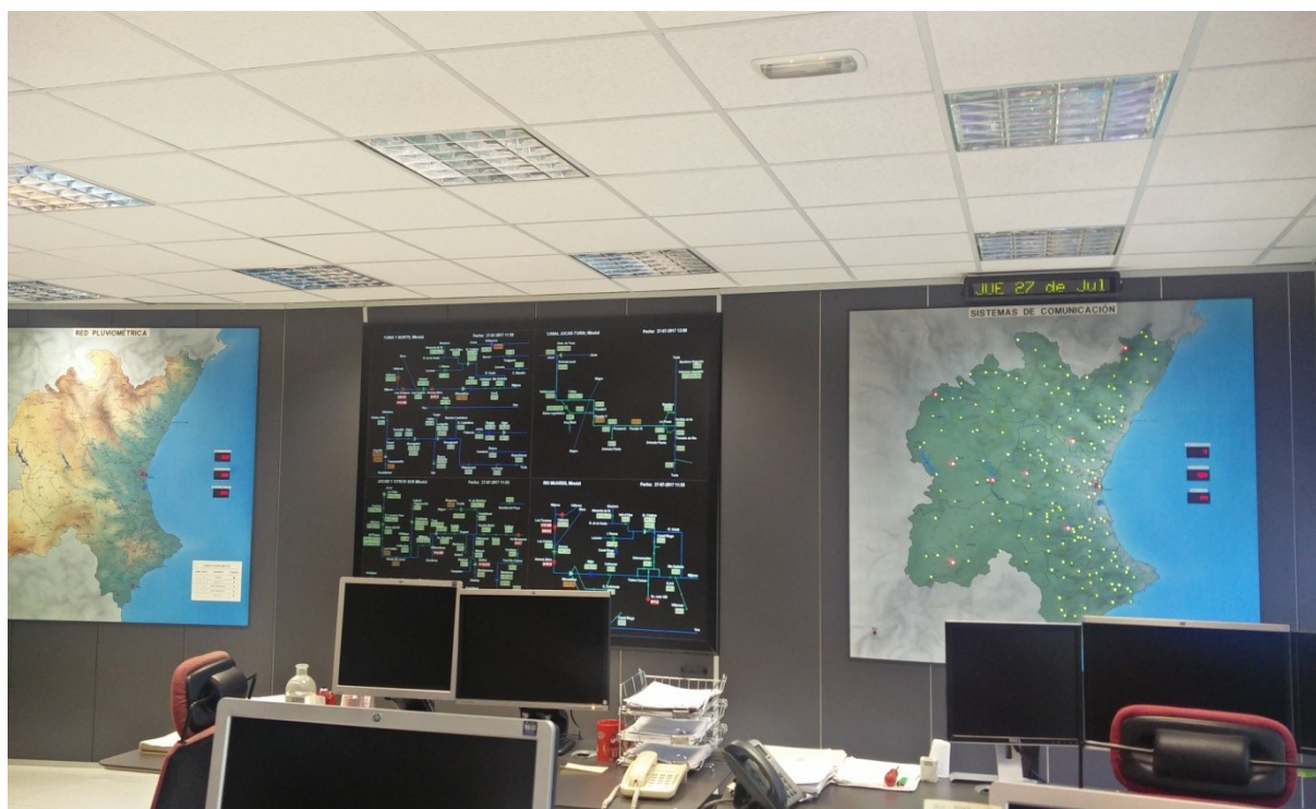
Paneles de control de lluvias y de comunicaciones del SAIH
