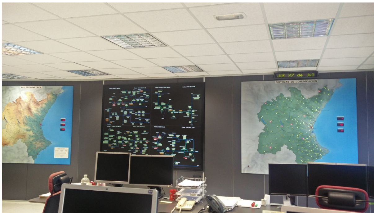
Paneles de control de lluvias y de comunicaciones del SAIH
