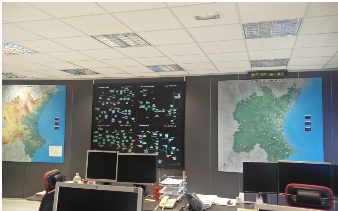
Paneles de control de lluvias y de comunicaciones del SAIH
