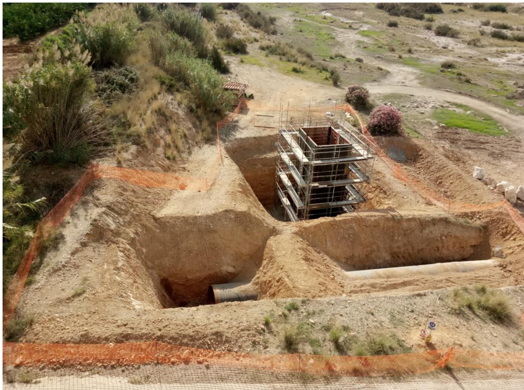
Arqueta de desagüe de conducción principal en río Magro
