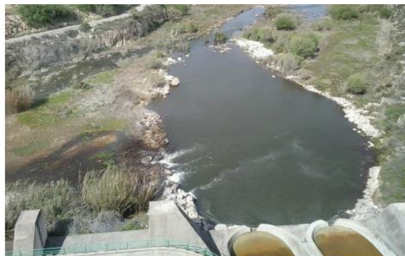
Estado del colchón antes del inicio de las actuaciones
