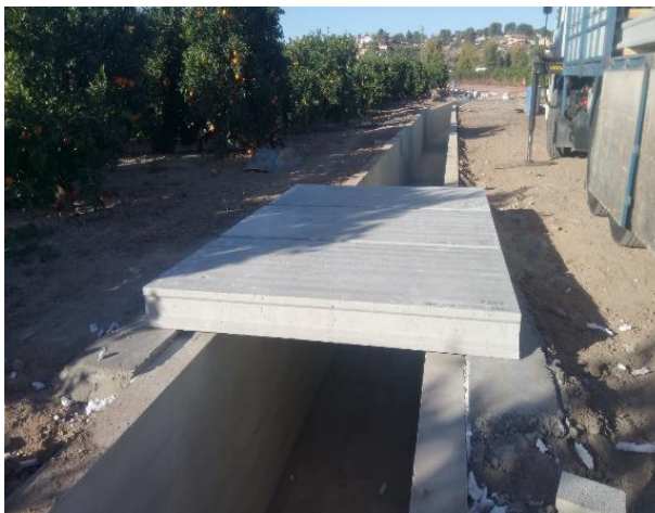
Losas de paso servicios afectados
