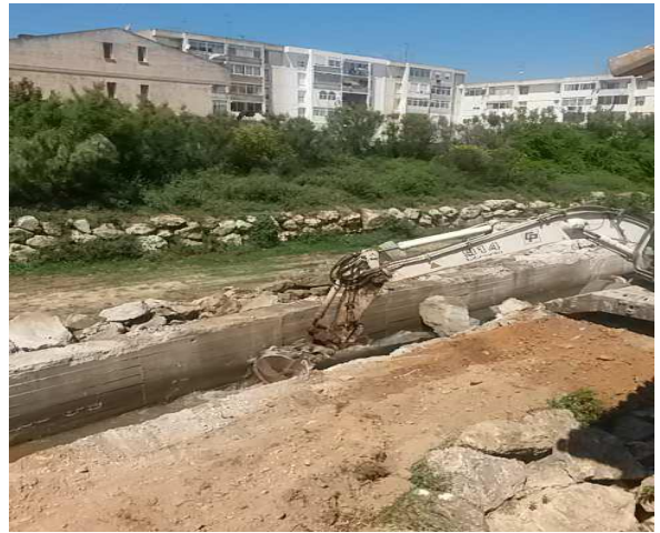
Demolición bóveda en mal estado
