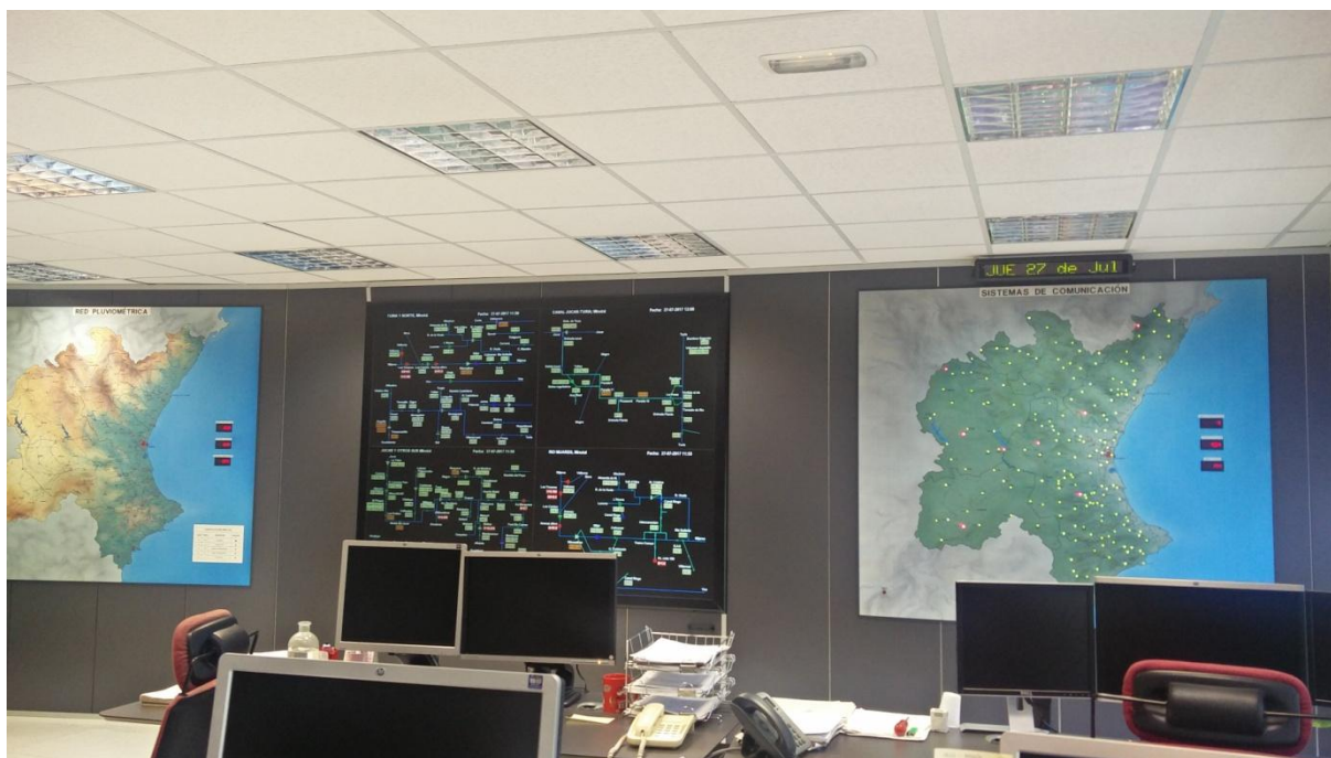
Paneles de control del SAIH
