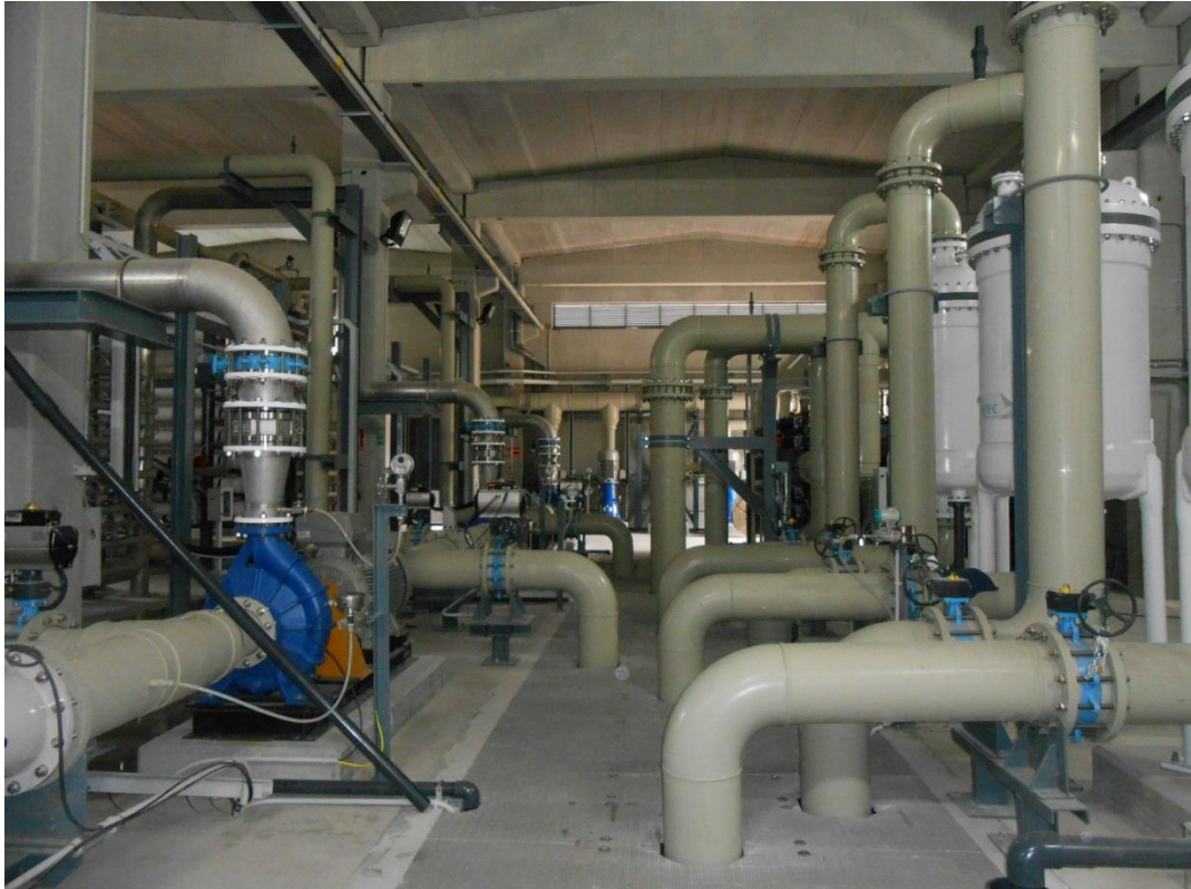
Filtros de cartucho y bombeo a ósmosis
