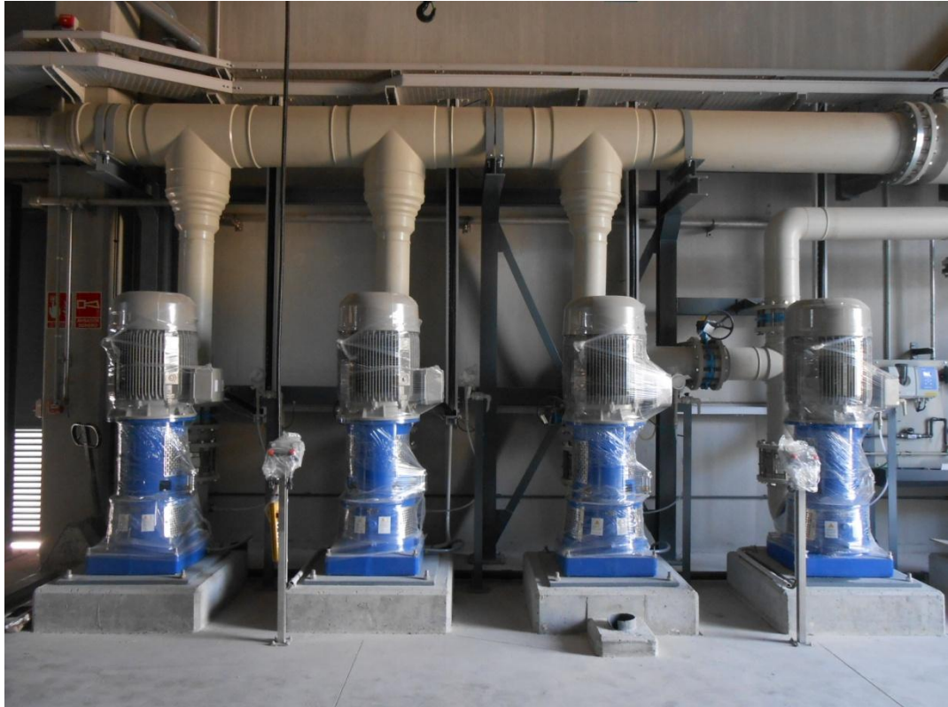
Bombeo de Agua Bruta
