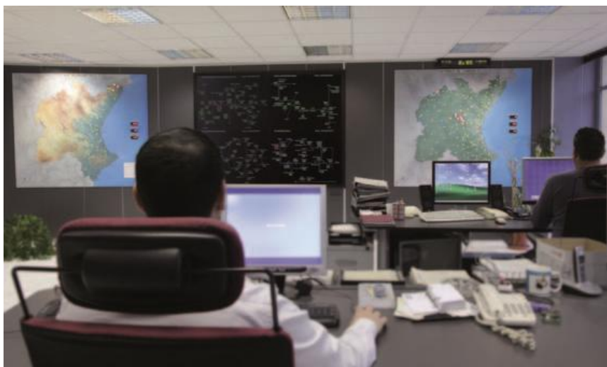
Sala de control del SAIH.
