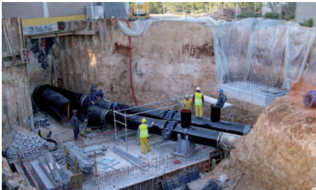
Detalle de la obra de la modernización de la Acequia Real del Júcar.
