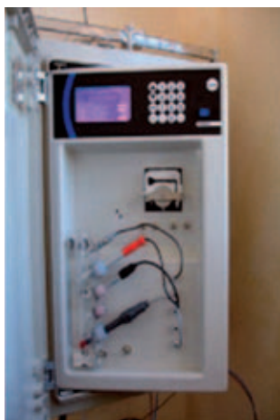
Detalle del equipo de medición de parámetros de calidad en continuo en la Gola de Pujol.
