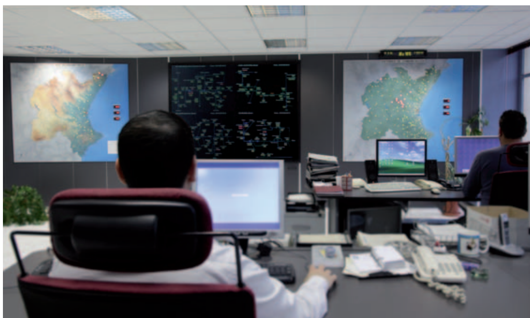
Sala de control del SAIH.
