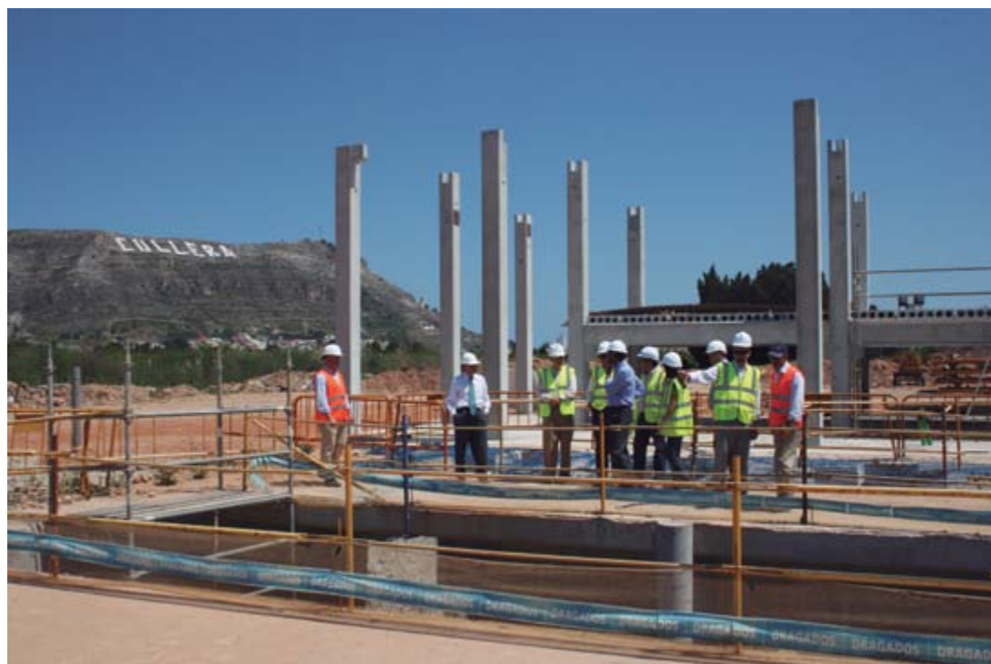
Estación de Bombeo en el azud de la Marquesa en Cullera
