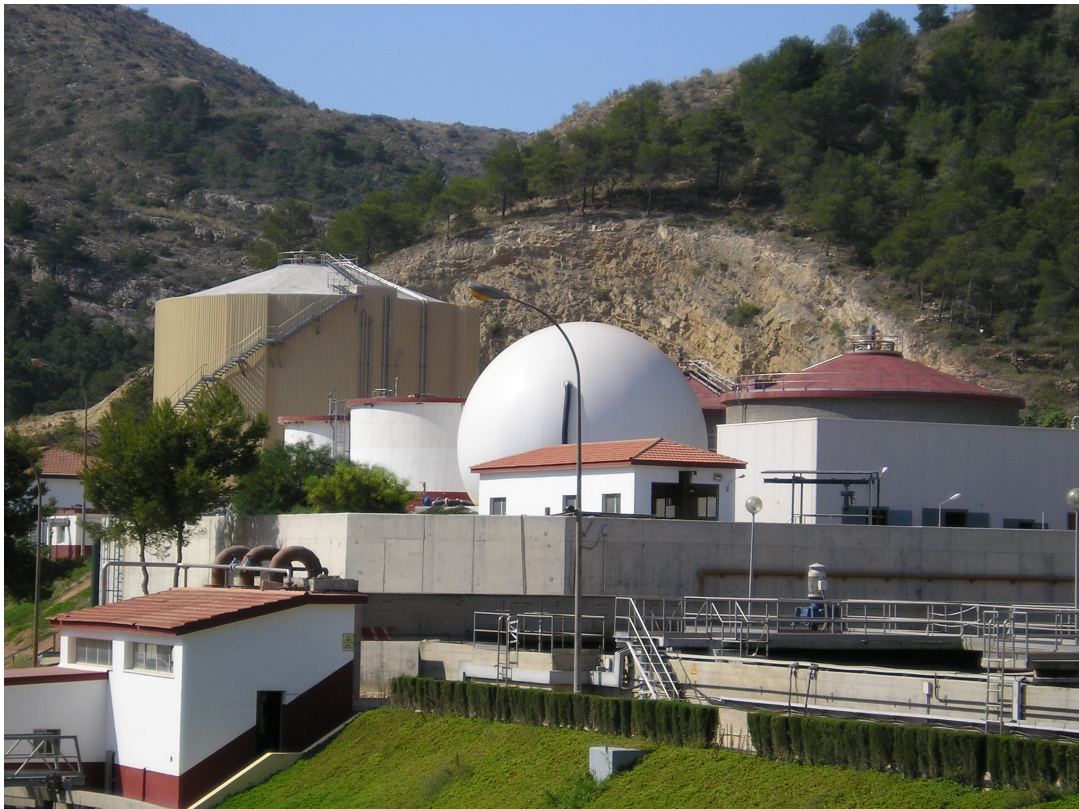
Línea de gas de la planta
