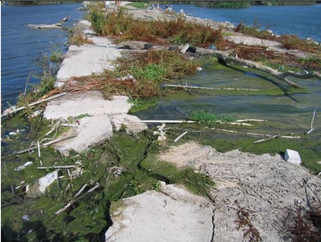
Grietas y filtraciones en coronación del Azud
