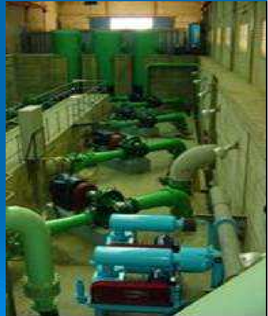
ESTACIÓN BOMBEO AGUA FILTRADA
