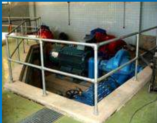
BOMBAS AGUA FILTRADA GRUPOS 9 A 11
