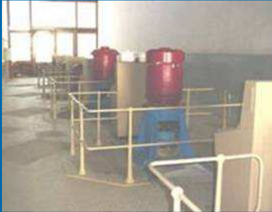
BOMBEO AGUA BRUTA BAJA Y ALTA 1
