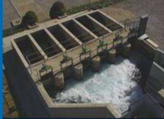
CÁMARA DE REPARTO
