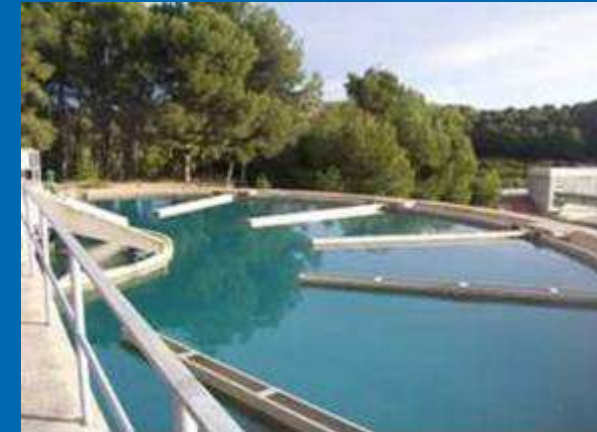
DECANTADORES CIRCULARES BAJA Y ALTA 1
