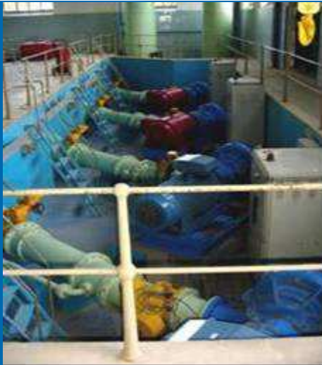
BOMBAS AGUA FILTRADA
