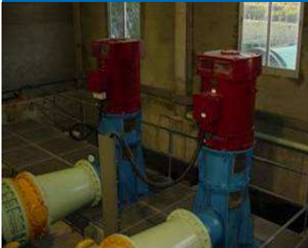
BOMBEO AGUA BRUTA ALTA2
