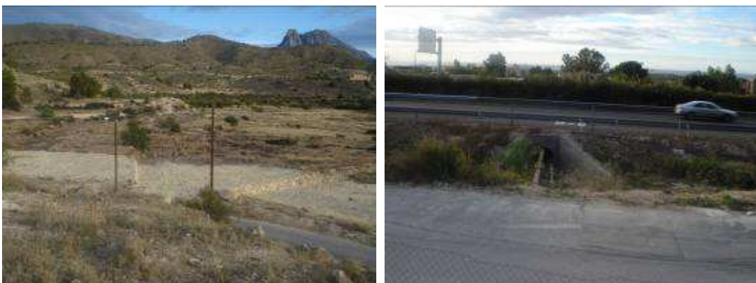
Racó de Juanillo y tubo de salida del drenaje de esta cabecera de fondo plano bajo la AP-7, parcialmente obstruido por otras conducciones.
