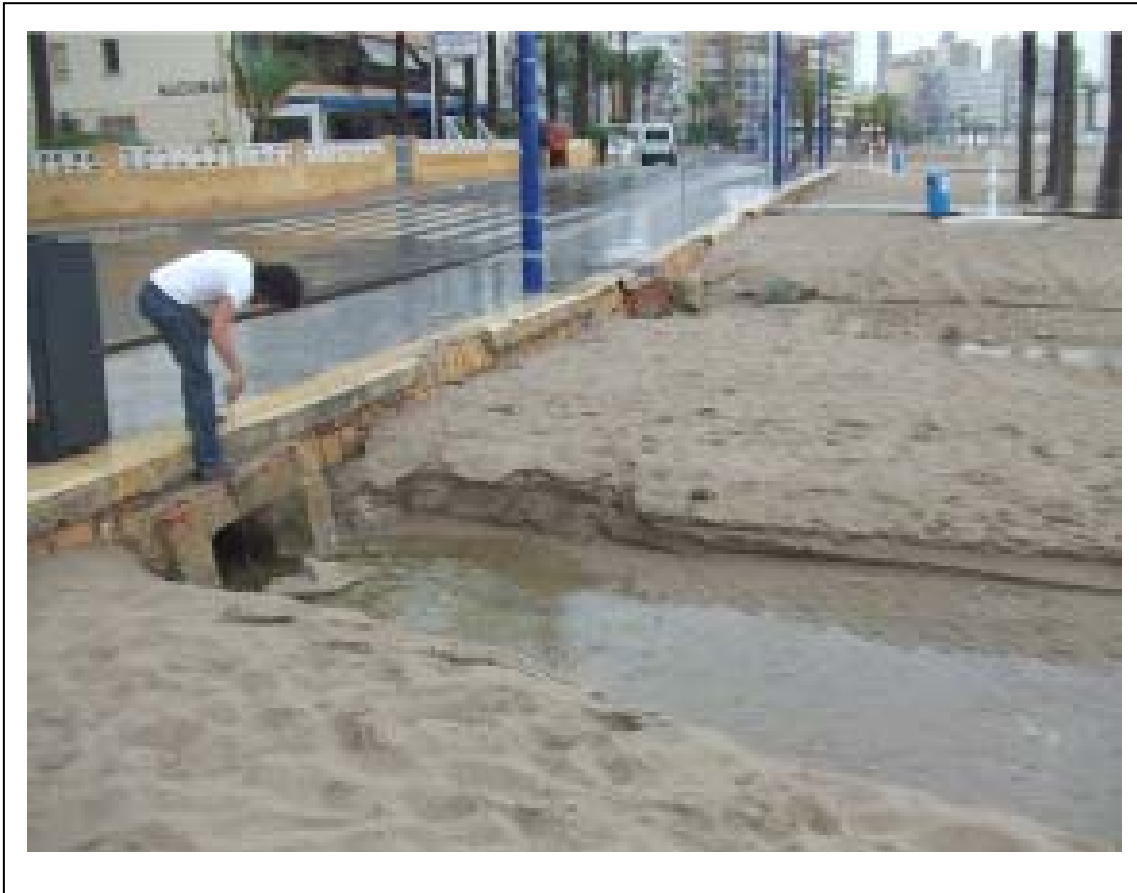
Vista desde aguas abajo de la obra de paso BEN-601 (Obra de drenaje de la Avenida de Vicente Llorca)
