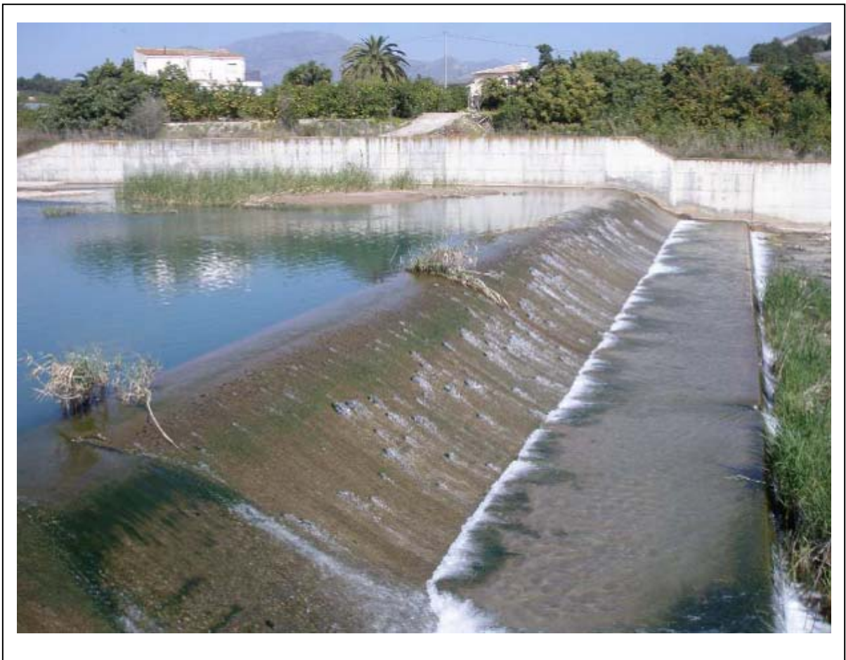
Paso denominado ALT-106, azud de riego en las inmediaciones de la sierra de Bernia
