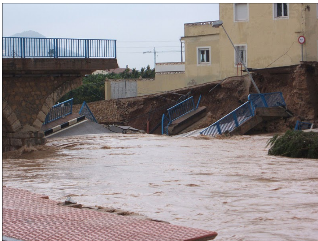
Figura 5: Daños Directos en las Infraestructuras. Destrucción de un puente en el Riu Girona (Fuente: Internet)
