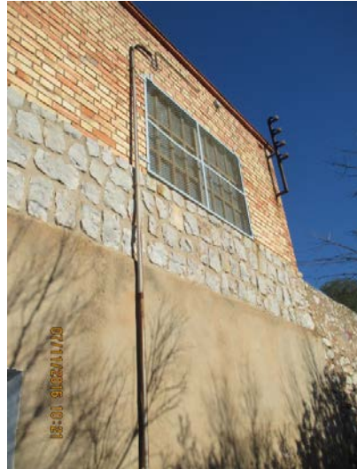
Fotografía 17 Exteriores – Edificio CT y CGBT – Canalización eléctrica planta sótano
