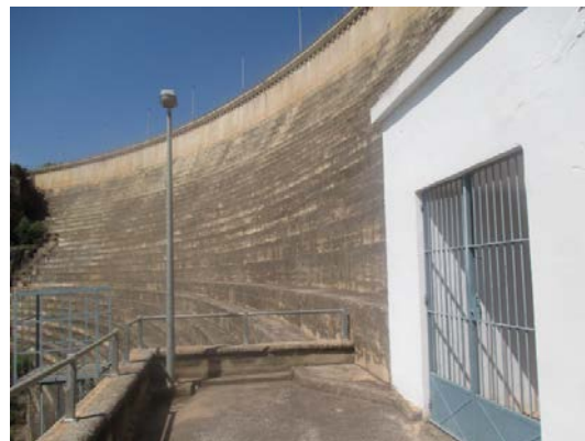
Fotografía 25 Exteriores – Desagüe de fondo – Acceso
