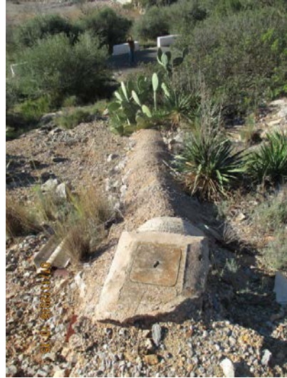
Fotografía 15 Exteriores – Canalización eléctrica Casa Administración
