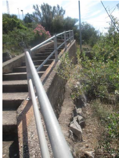
Fotografía 23 Exteriores – Escalera – Canalización eléctrica
