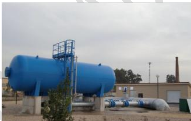
Figura 36. Estación de bombeo en el puerto de Catarroja
