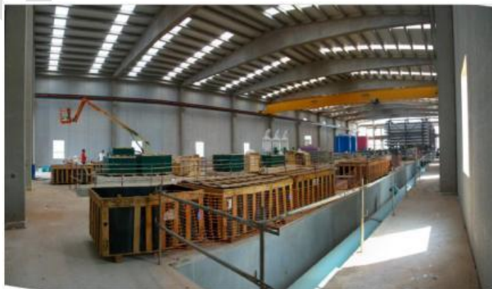
Figura 43. Nave de proceso en la IDAM Moncófar
