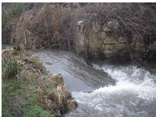
Figura 17: Azud Acequia de las Compuertas, actualmente en ruinas. Se propone su eliminación
