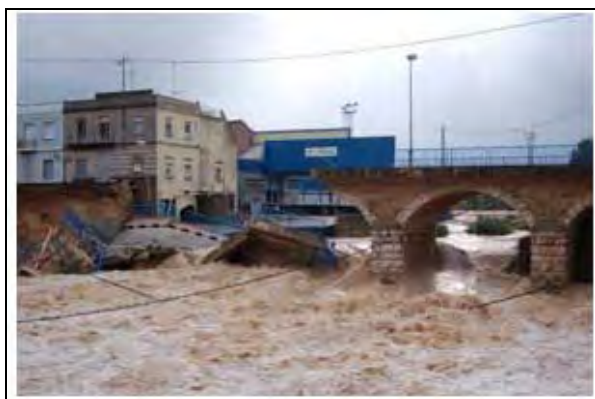
Figura 7 Afección al antiguo puente de Beniarbeig (río Girona).
