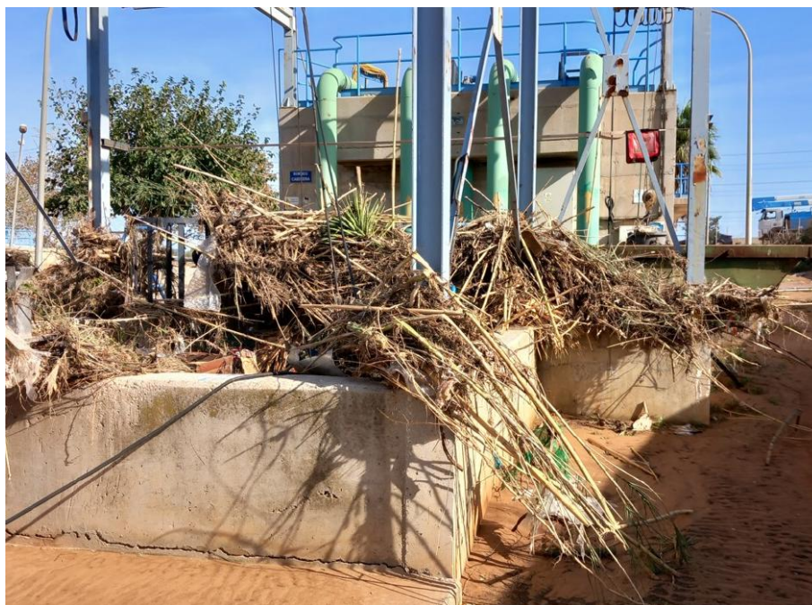
Restos de maleza acumulados en las instalaciones de la EDAR de Torrent.
