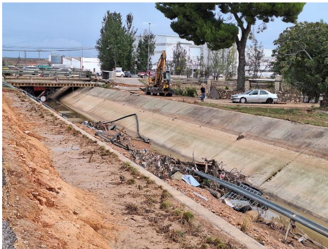
-Rotura de bionda y obstrucción del canal-
