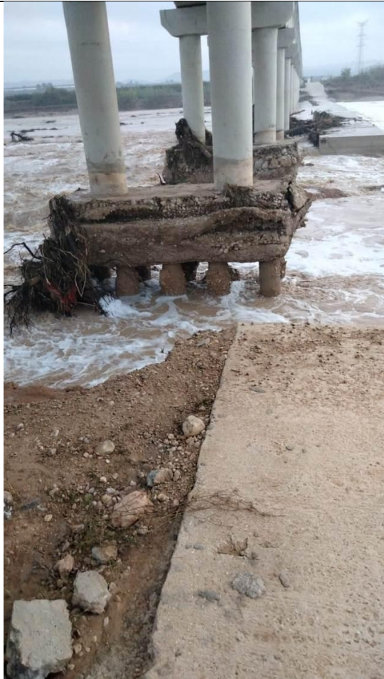
-Estado de las pilas del acueducto-
