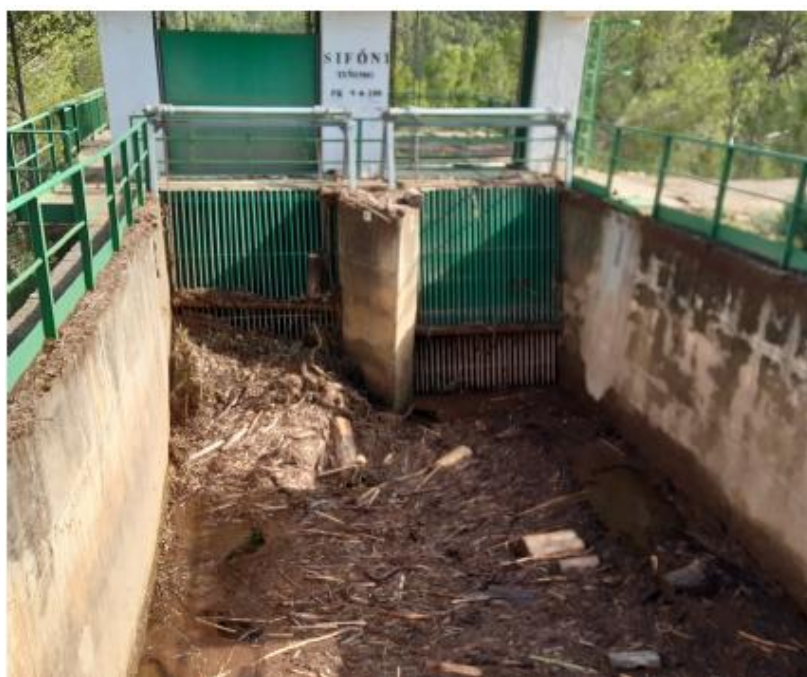
Desprendimientos y arrastres en el interior del CCT
