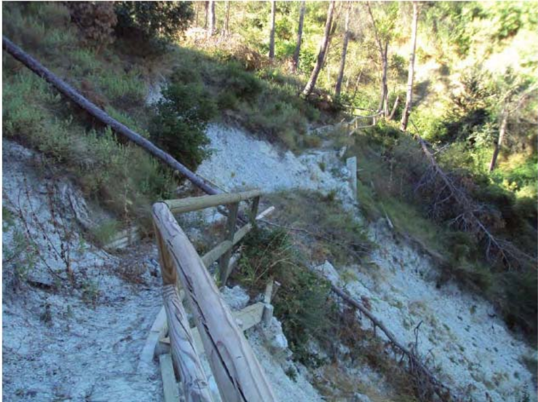
Detalle del deslizamiento de ladera que arrastró parte de la senda existente.
