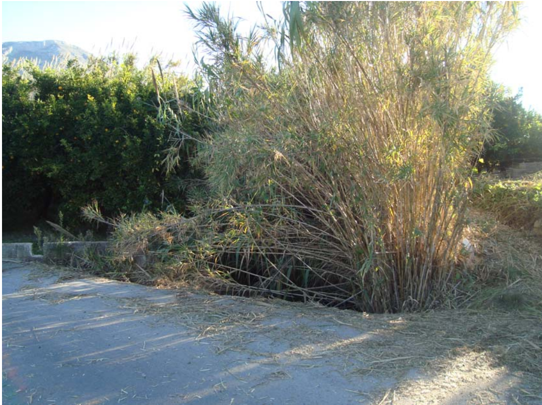
Estado de la vegetación invasora y obstructiva en taludes y lecho.
