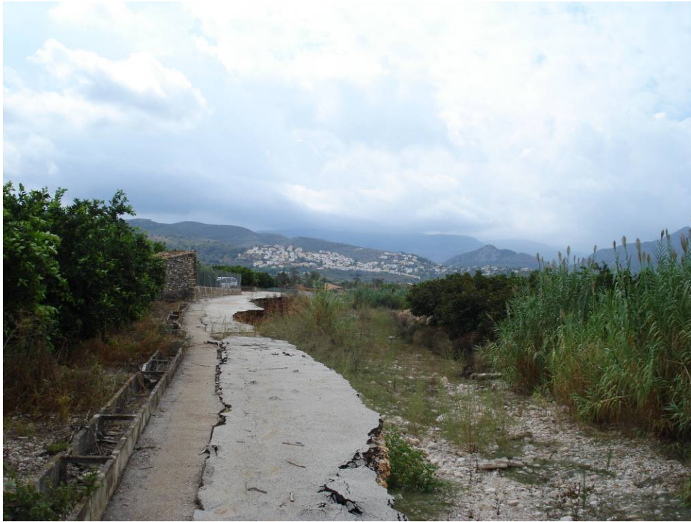
Estado previo de la margen derecha, con los daños en el camino de Rafol en primer plano.
