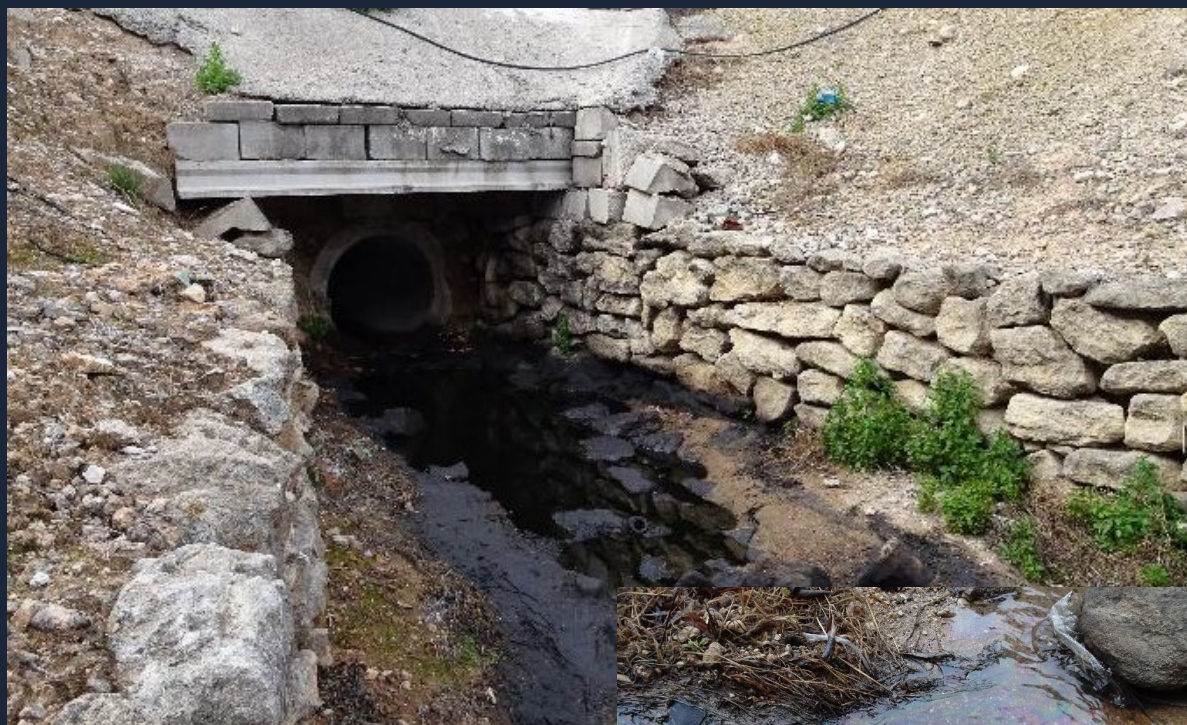
Vertido de aguas de escorrentía pluvial con elevada presencia de hidrocarburos Fuente: CHJ
