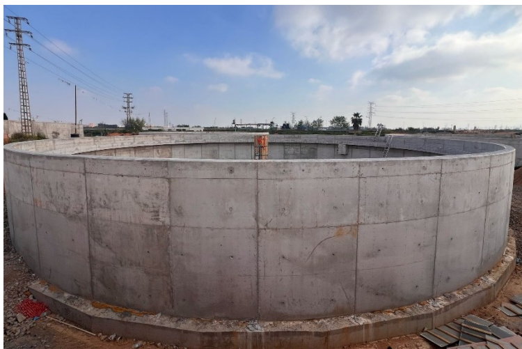
Decantador secundario nº3
