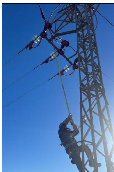
Mantenimiento y revisión de las líneas de alta tensión de la presa de Tous
