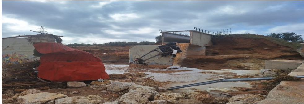
Rotura del acueducto de la Horteta
