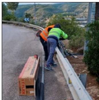
Reparación de tubería de agua en coronación de la presa de Tous
