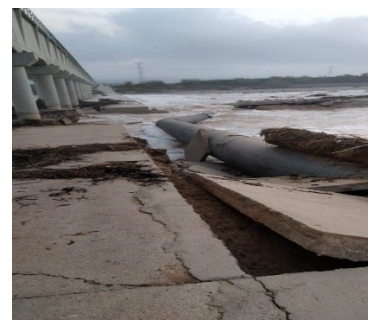
-Estado del by-pass del Magro-
