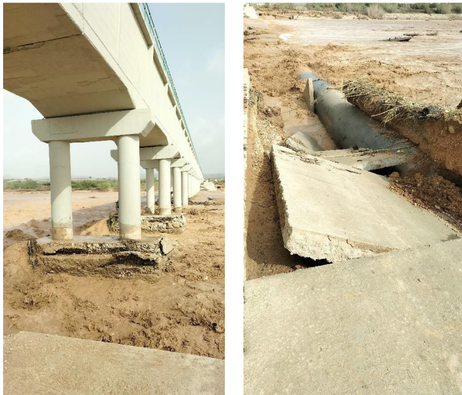
Trabajos de mantenimiento correctivo con el seguimiento de las Obras de Emergencia de la DANA de octubre de 2024. Roturas en el Canal del Magro.
