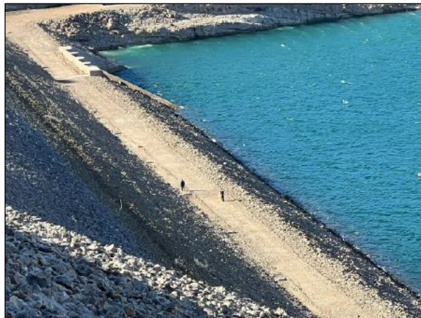
Realización de campañas topográficas periódicas en las presas de Tous y Escalona
