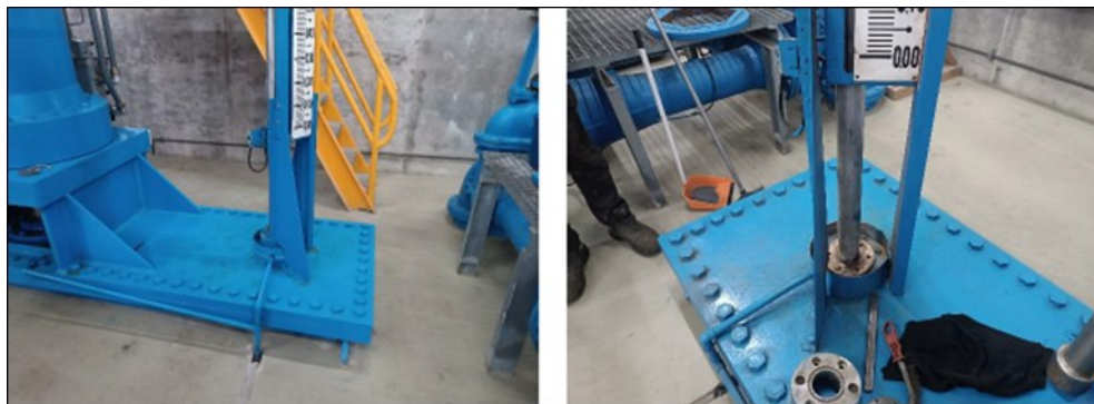
Reparación de las empaquetaduras de las barras indicadoras de las compuertas Bureau del Desagüe Intermedio de la presa de Tous
