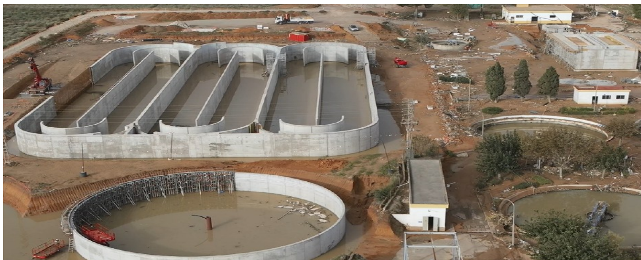
Estado de la EDAR de Torrent después de la DANA del 29 de octubre de 2024.
