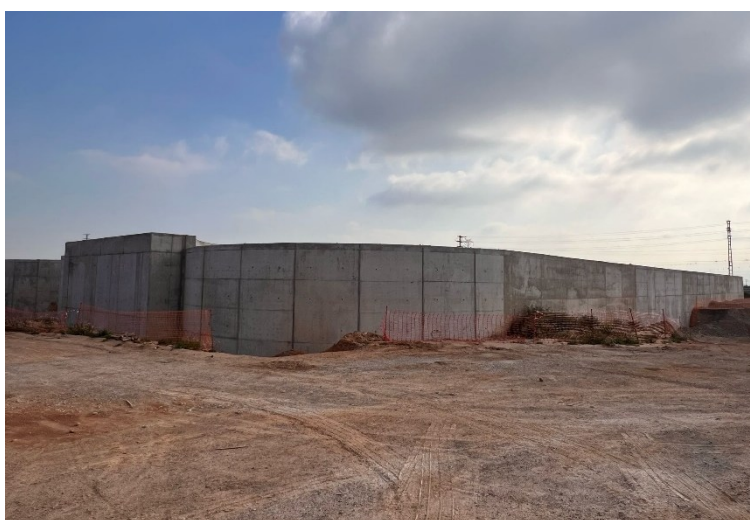
Muros reactores biológicos
