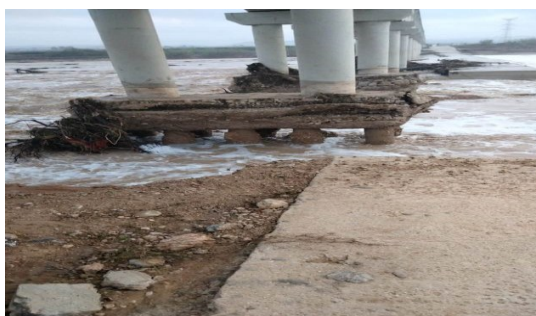
-Estado de las pilas del acueducto-
