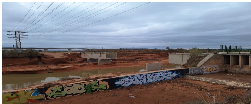
Rotura del acueducto del Poyo
