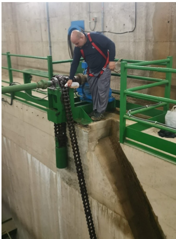
Engrase de cadenas galle de la compuerta taintor de la Toma del Canal (Benageber)
