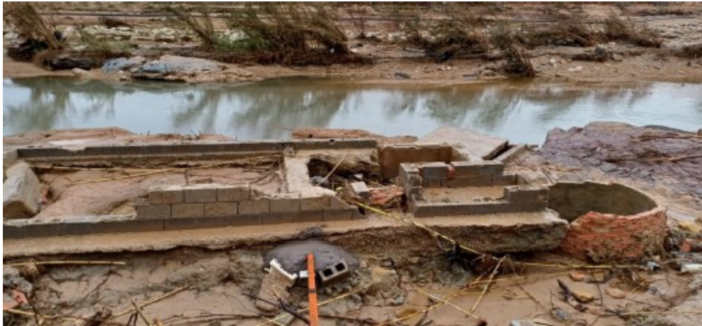
Restos de la estación de bombeo. Alojaba junto a la bomba, el equipo del centro de transformación.
