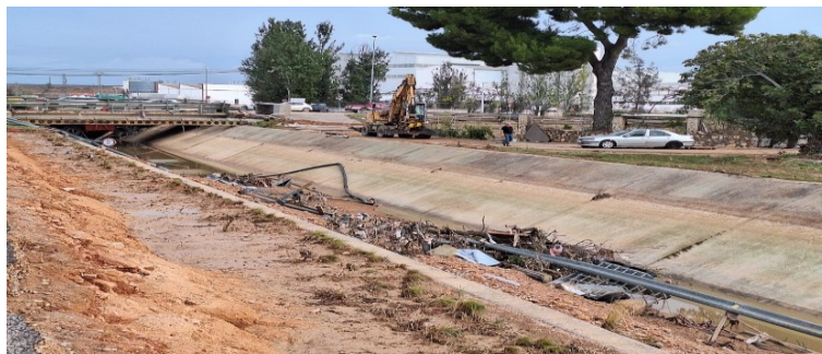
-Rotura de bionda y obstrucción del canal-
