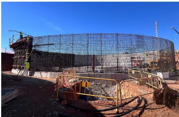
Decantador secundario nº3
