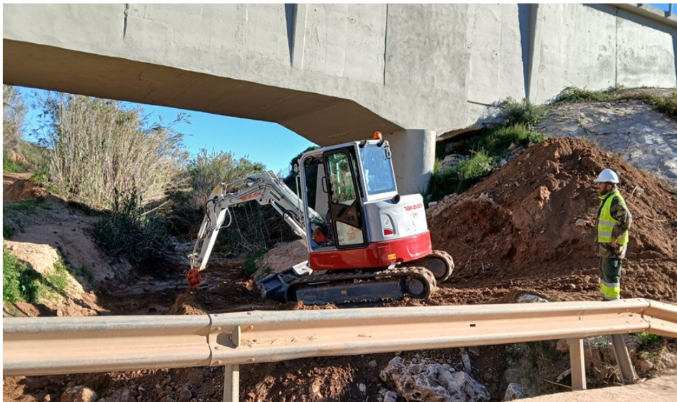
Limpieza del barranco de las Cañas a la altura del Acueducto nº 15. Daños causados por la Dana de octubre 2024.
