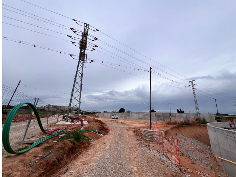
Torre eléctrica zona sur EDAR
