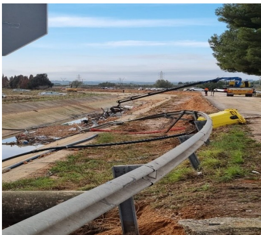
Estado del canal
