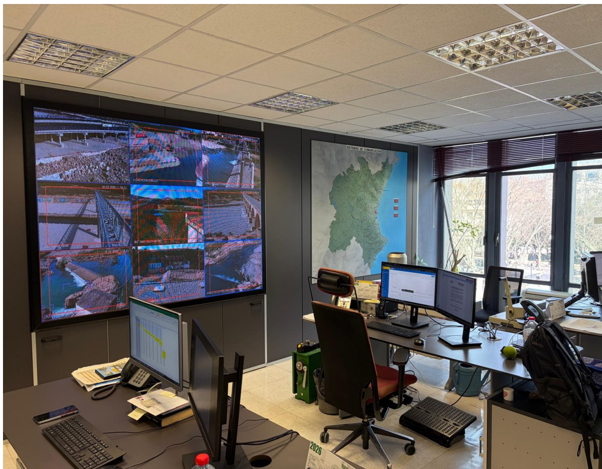
Sala de control del SAIH
