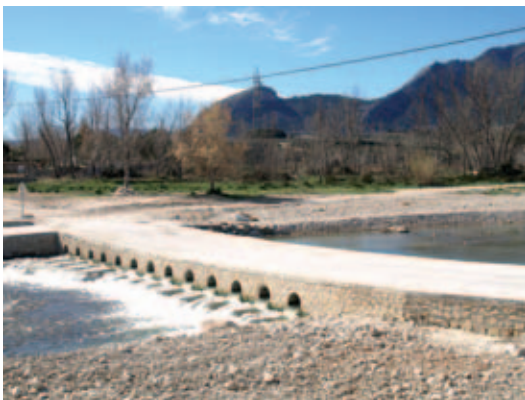
Adecuación del río Serpis a su paso por Alquería de Aznar (Alicante).
