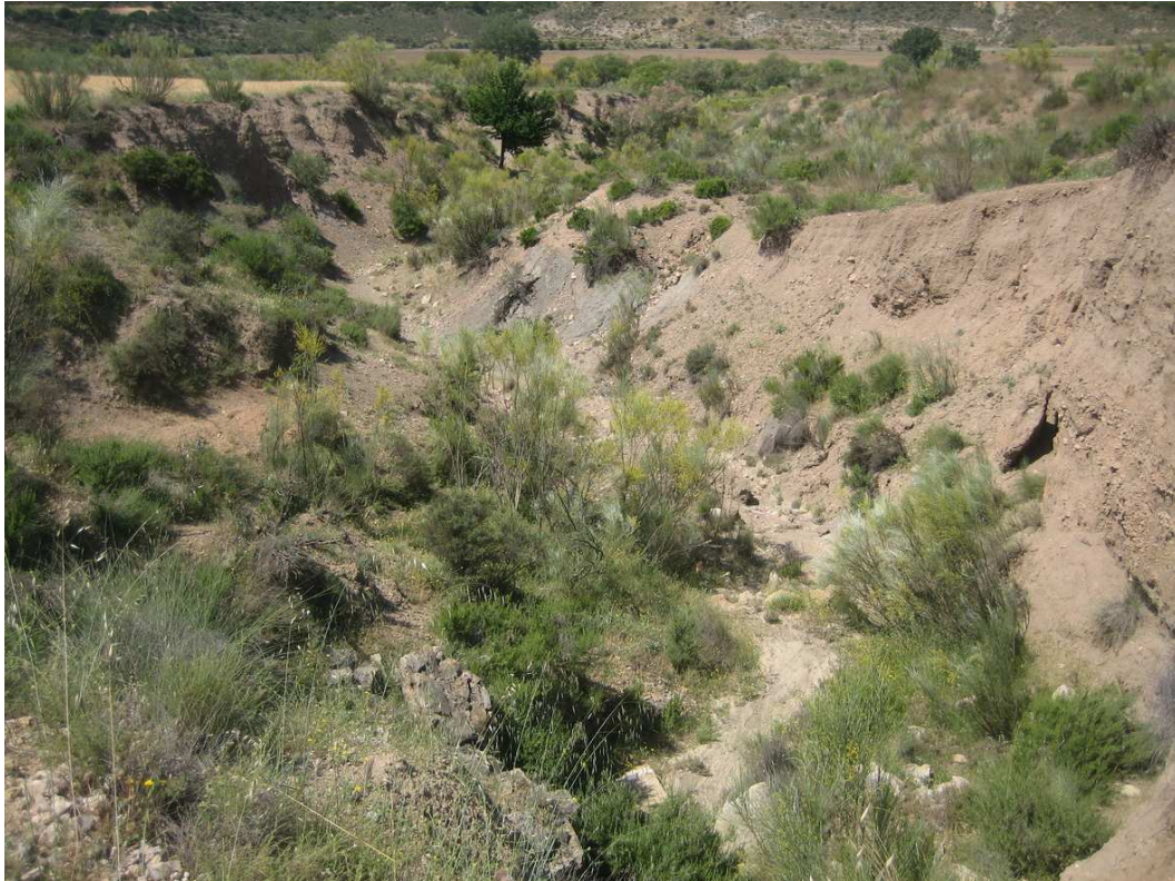
Fotografía nº 23: Construcción de gaviones. Vista de uno de los barranquizos que están erosionando de manera importante las márgenes, debido a su poca resistencia, poniendo en peligro la estabilidad del camino.
