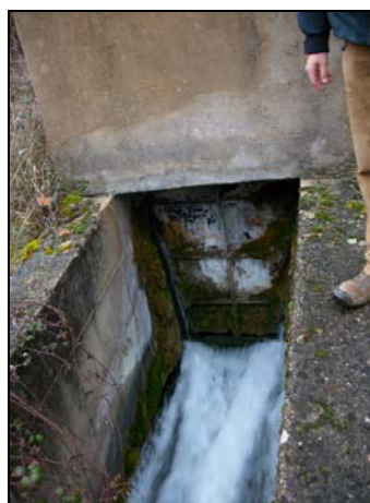
Figura 35. Vista de la compuerta del manantial. Filtraciones.
