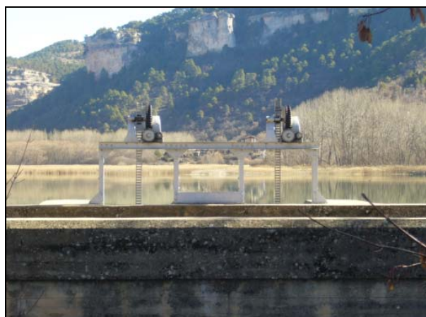
Figura 20 Compuerta que regula el agua que sale hacia el río Júcar
