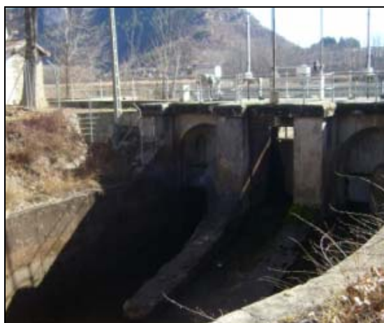
Figura 23. Compuerta que regula la salida de agua de la laguna al canal
