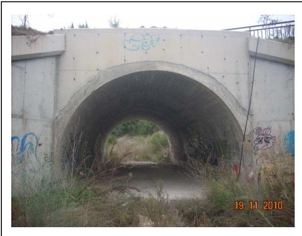
Puente de entrada a la Urbanización Terra Mítica. Sección circular de 6 m de base y 4 m de altura
