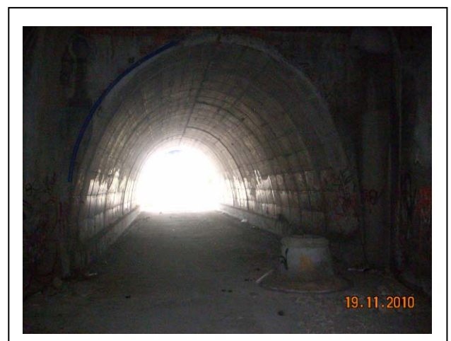
Paso inferior Ferrocarril y calle Alicante. Bóveda de 5 metros de base y altura.
