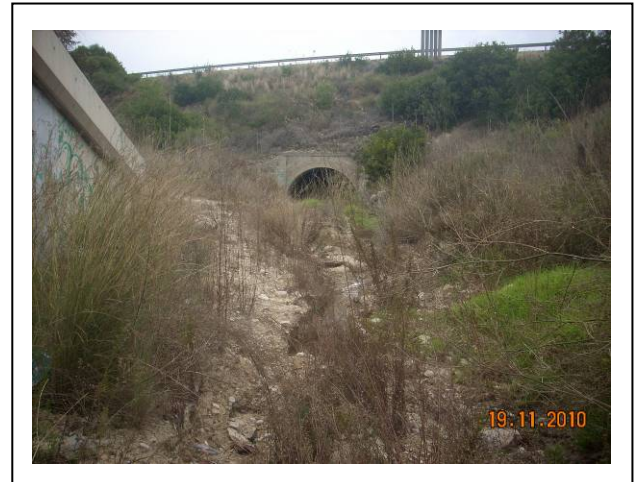
Transición entre el puente anterior y el paso bajo la autopista AP-7
