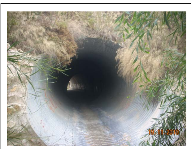
Paso inferior del Ferrocarril. Tubo de chapa de 4.50 m de diámetro
