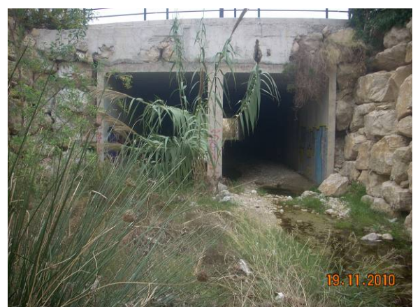
Cruce inferior rotonda c. Jaime I con c. 9 de Octubre. Dos marcos de hormigón armado de 3.00x3.50 metros.
