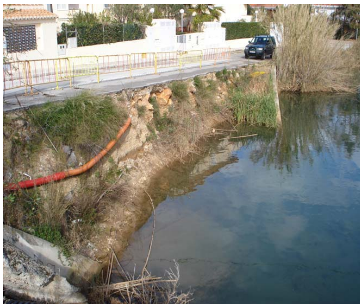
Foto 3: Tramo con viviendas afectadas por inundaciones del bco. de la Alberca
