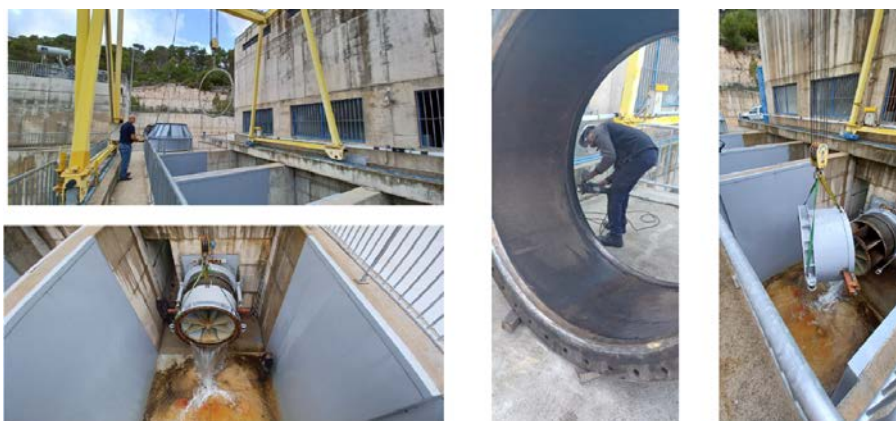
Acondicionamiento y modificación de cierres de estanqueidad de válvulas Howell Bungler de la presa de Alarcón.
