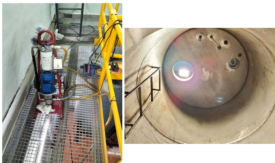
Vaciado, filtrado y reposición de aceite en desagüe de fondo, incluso gestión de residuos, de la presa de Tous.
