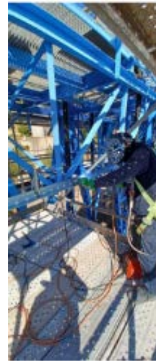
Reparación y pintado de la estructura metálica de las cántaras de la presa de Tous.
