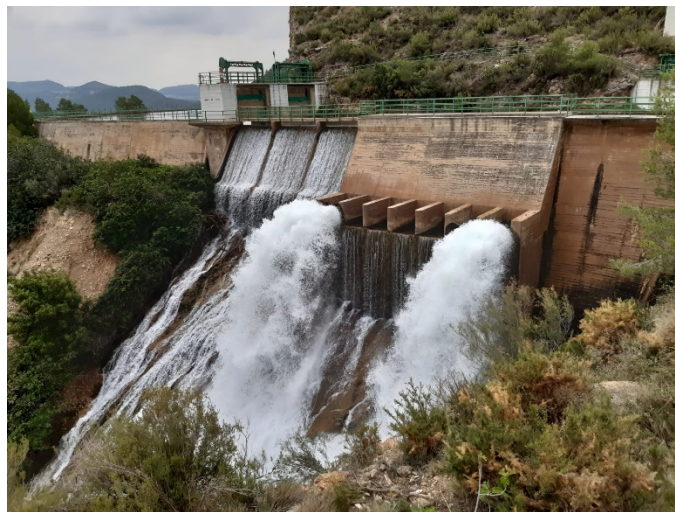
Sensorización de compuertas de corte y desagüe
