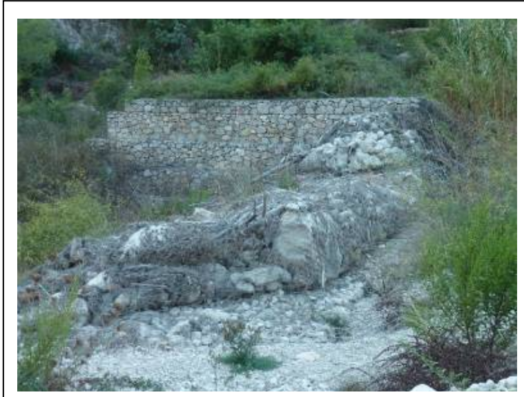
Presa de retención de sedimentos (gaviones) situada aguas arriba del estrecho desmoronada durante las crecidas recientes de 2007-2008.
