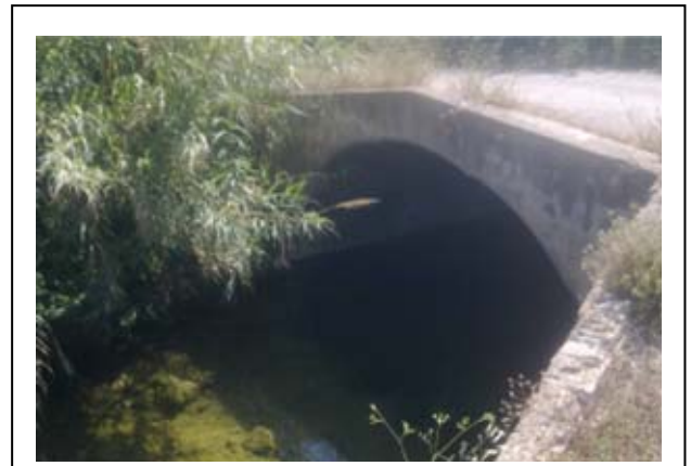
Vista del pontón de un camino privado, obra de paso CALL102 en el río Bolulla
