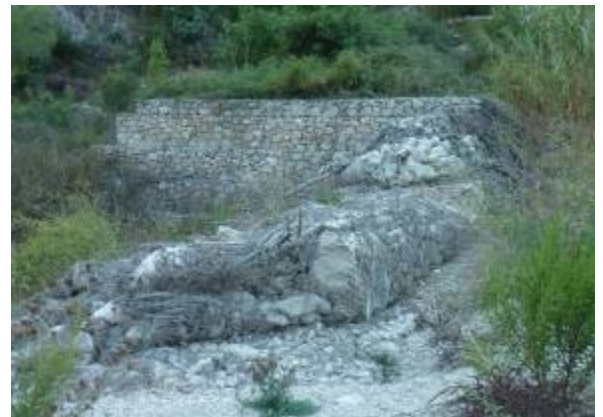
Presas de retención de sedimentos situada aguas arriba del estrecho desmoronada durante las crecidas de 2007-2008.
