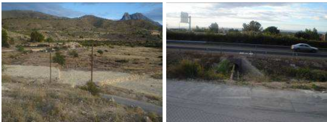
Racó de Juanillo y tubo de salida del drenaje de esta cabecera de fondo plano bajo la AP-7, parcialmente obstruido por otras conducciones.
