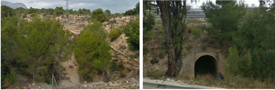
El Derramador desde la AP-7. Se observa carga gruesa en el lecho, taludes compuestos por capas alternas de materiales sueltos y encostrados y un paso inferior notablemente menor al cauce de avenida.
