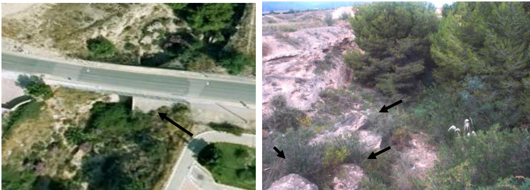
El puente de acceso a los centros educativos del Salt de l'Aigua reduce también la sección del cauce de avenida. Desde éste se observa también como la alternancia de capas encostradas y sedimentos poco compactados favorece la caída de grandes bloques sobre el lecho.
