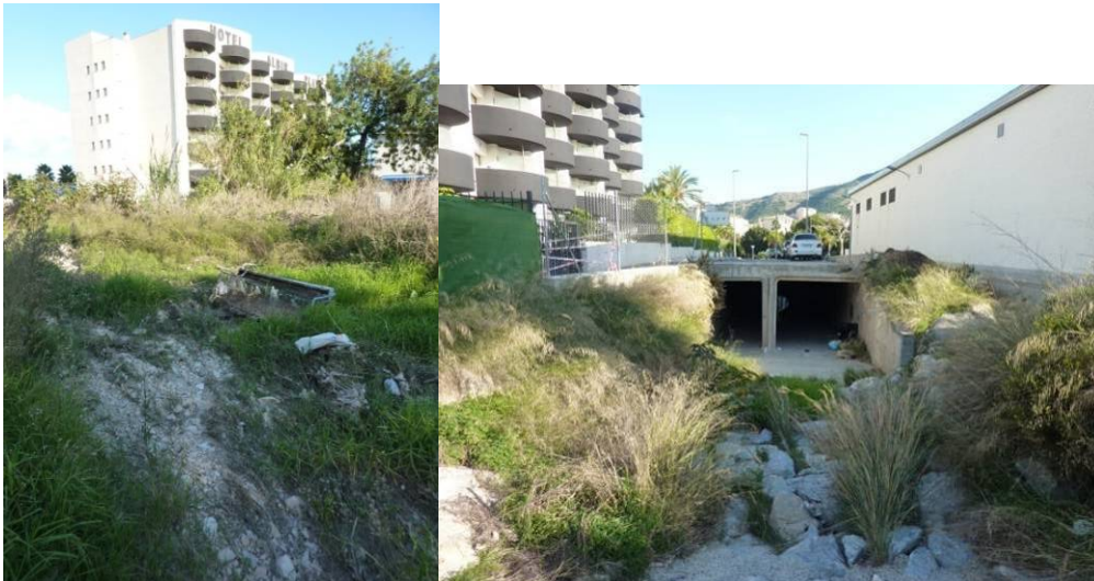
Arrastres de crecidas recientes sobre un solar al final del carrer Rambla de l'Albir e inicio canal cubierto junto al hotel Albir Playa.
